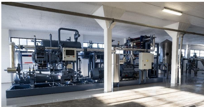
Figur 3-11: Høytemperatur varmepumpe ved Felleskjøpet i Trondheim som produserer damp ved ca. 120°C. Foto: Aneo Industry
