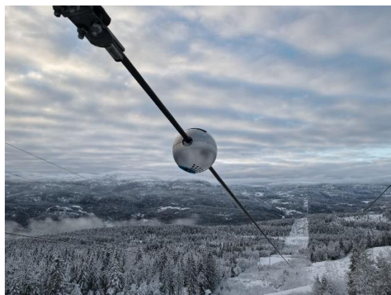
Figur 3-5: Neuroner™ er sensorer som måler blant annet strøm i kraftledningen, vind og lufttemperatur, og gir informasjon om tilgjengelig kapasitet. Foto: Heimdall Power
